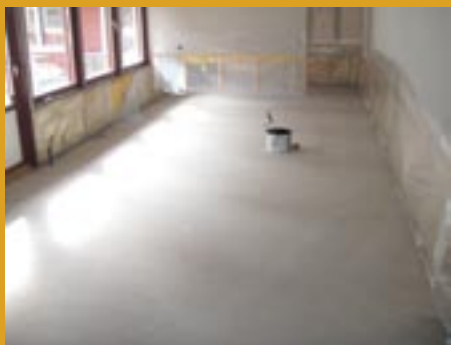
Golvet har flytspacklats upp till jämn nivå. Ytorna dammsögs innan montering av Optiventsystemet.
