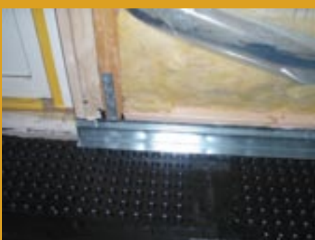
Längs med ytterväggarna tätades systemet med syllkanaler som även fungerade som tilluftskanaler i vissa delar av systemet.
