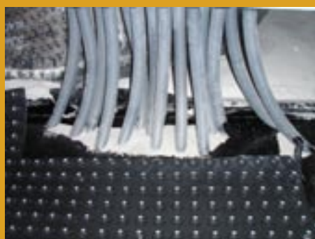
Blacklinematta lades fram till genomföringar och tätades ner mot golvet med Fogband och Stuck & Seal.
