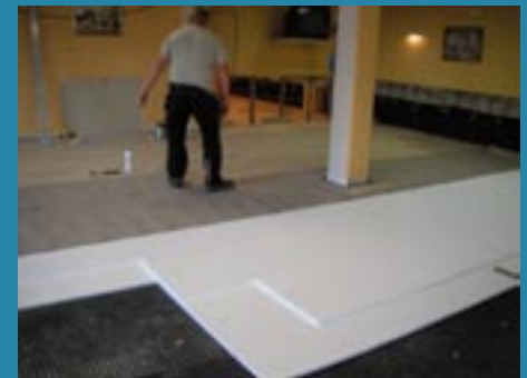
Alla åtgärdad golv är belagda 60 mm golvcellplast, lumppapp samt 18 mm golvspånskiva. Spånskivan är senare belagd med matta, vilket ej ingick i vårt åtagande.
