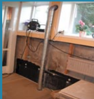
Frånluften går via spirorör vidare ut till utvändig fläkt, detta har byggts in i en slits. I denna slits sitter även trafo (styrehet) och tryckvakten.
