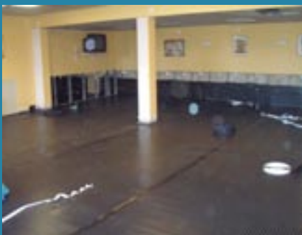
Alla fuktutsatta golv och väggar har försetts med Opti Vent undertryckventilerat system från Fuktspärsteknik
